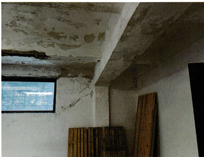
Foto 6 Styk stropního trámu a průvlaku a napojení sloupu – viditelné projevy vlhkostních poruch
