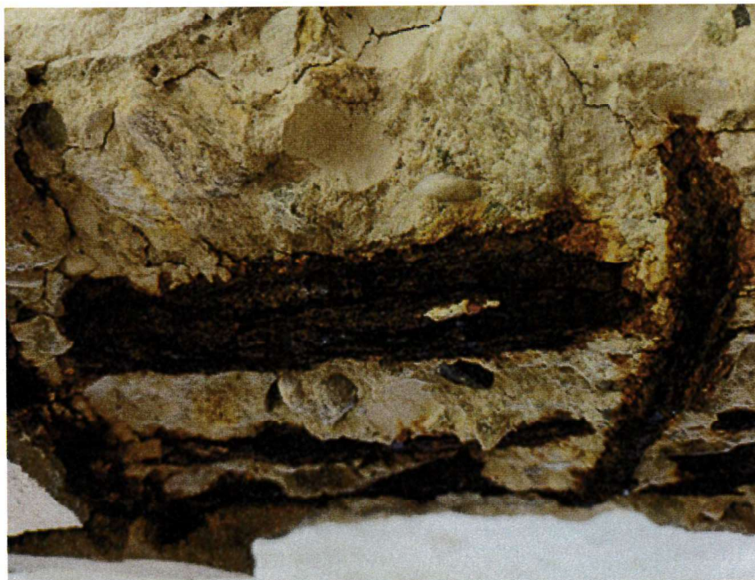
Foto 3 Stropní trám – detailní pohled na obnaženou spodní výztuž a třmínky
