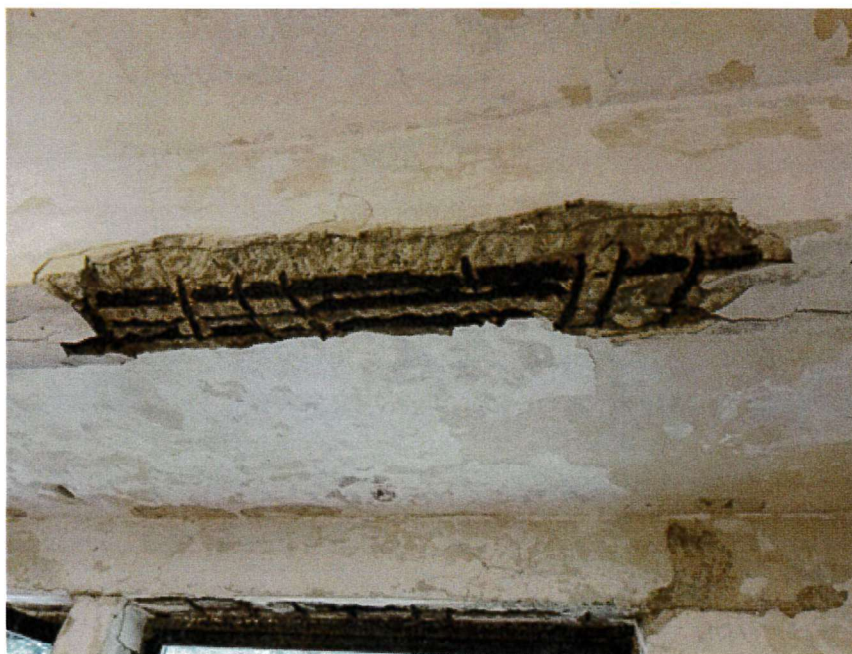
Foto 2 Stropní trám - detailní pohled na obnaženou spodní výztuž a třmínky
