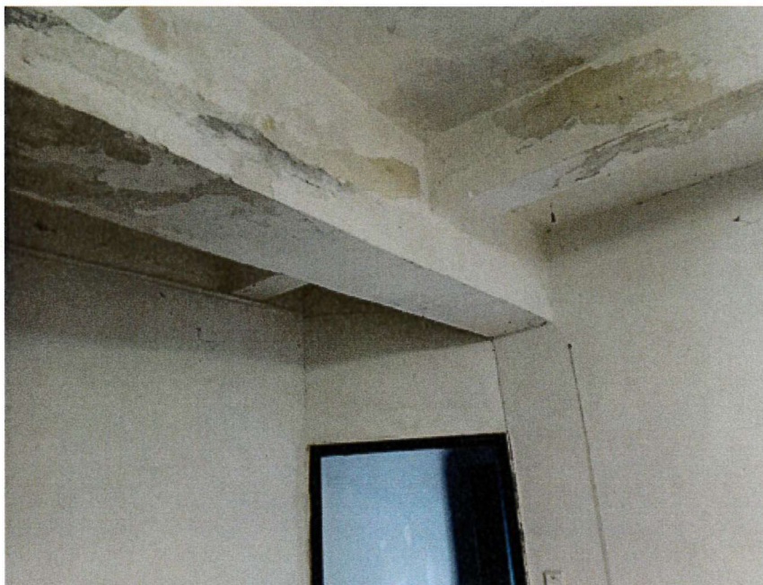
Foto 5 Styk stropního trámu a průvlaku – viditelné projevy vlhkostních poruch
