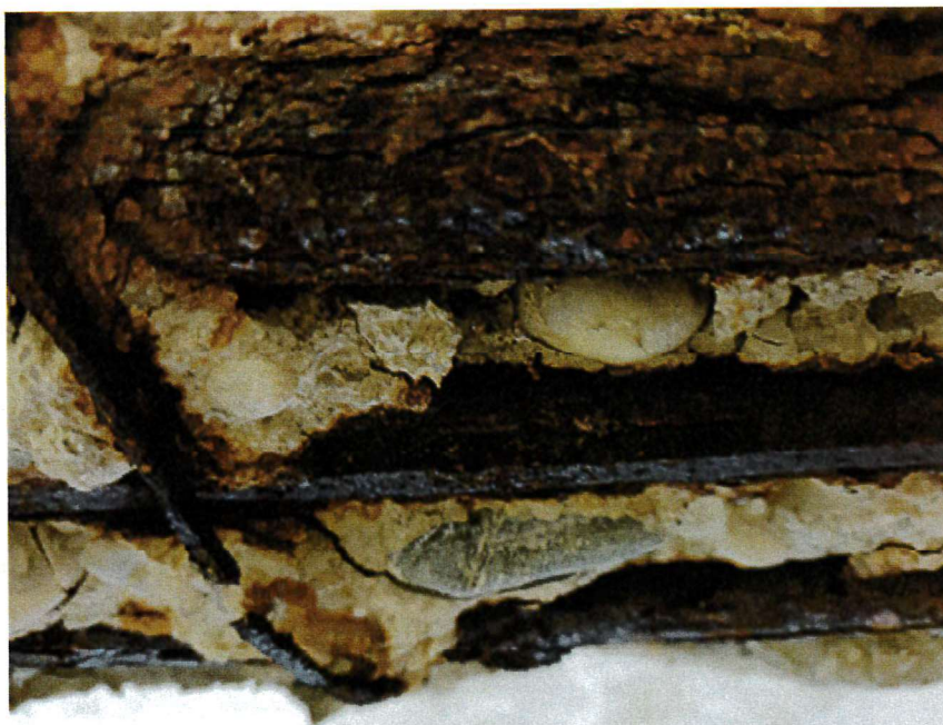
Foto 4 Stropní trám – detailní pohled – výrazné korozní úbytky spodní podélné výztuže
