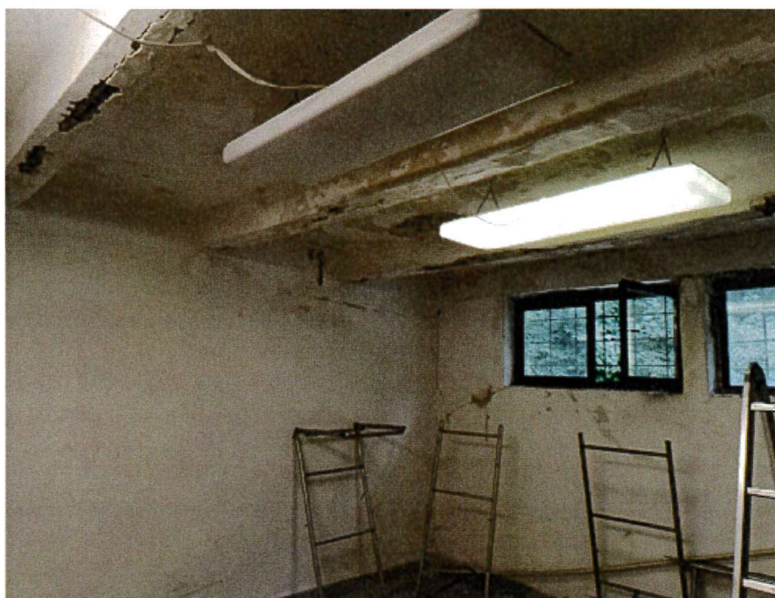
Foto 1 Stropní trámy - krycí vrstva výztuže uvolněná/odpadlá/degradovaná
