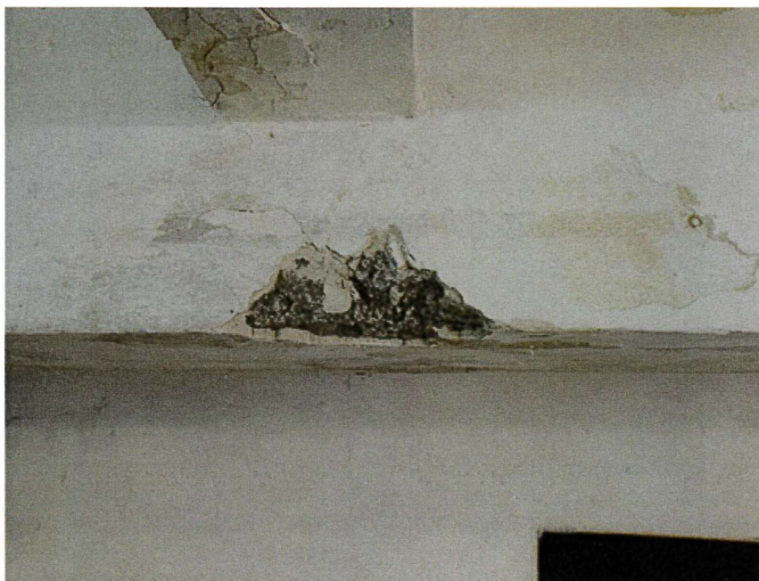
Foto 9 Sonda ke zjištění průběhu praskliny na styku stropního trámu a průvlaku
